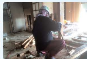
常総市 浸水被害ボランティア
