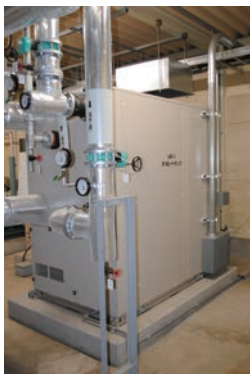
新宇都宮工場のヒートポンプ
