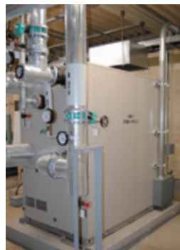
新宇都宮工場のヒートポンプ
