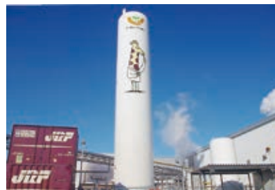
LNGサテライトの貯蔵タンク
