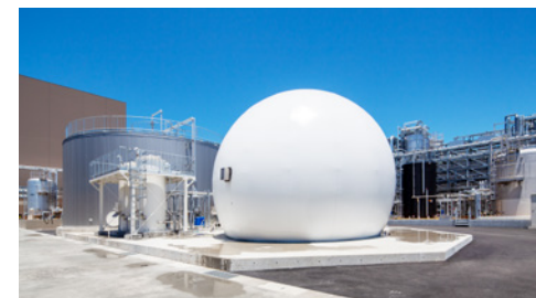
せとうち広島工場のメタン発酵設備
